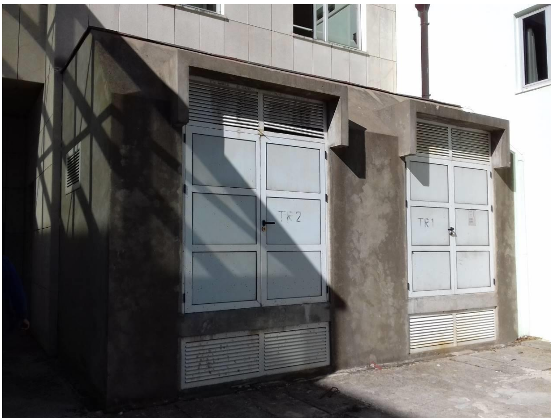
Slika 5. Trafostanica TS-2 10/0,4 KV
