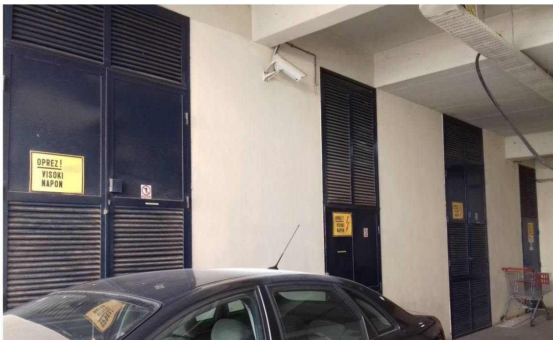
Slika 4. Trafostanica TS-1 10/0,4 KV
