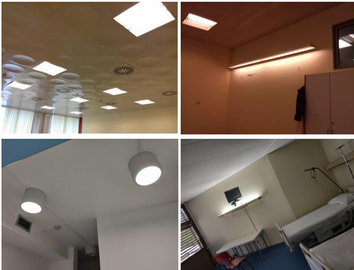
Slika 4. Primjeri postojeće rasvjete
