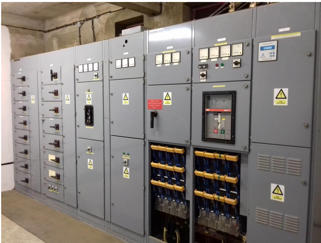
Slika 6. Trafostanica TS-3 10/0,4 KV
