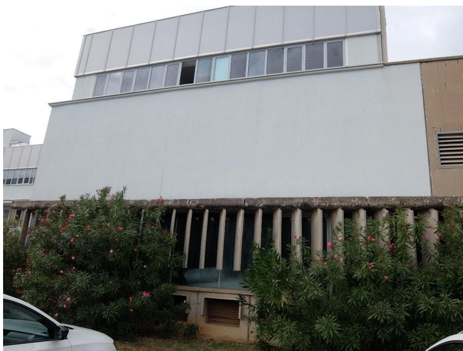
Slika 26: Istočno pročelje dilatacije E
